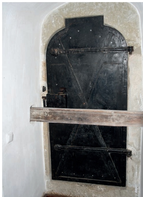
Fig. 50. Ușa de intrare în camera de la etajul al II-lea, vedere din interiorul încăperii
