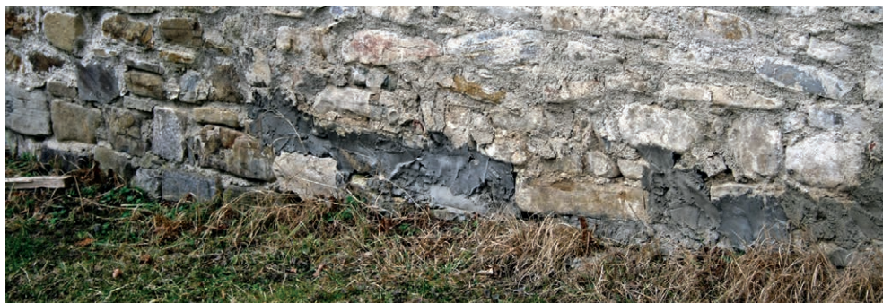
Fig. 107. Deteriorări ale zidului de incintă în zona de transfer a umezelii
