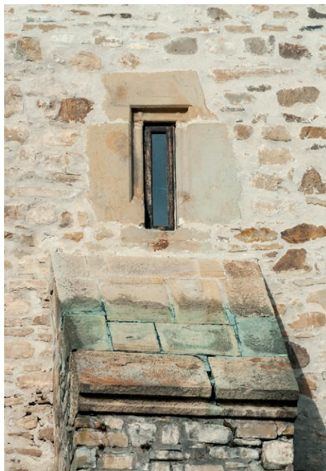
Fig. 52. Lacrimar la acoperișul unui contrafort
